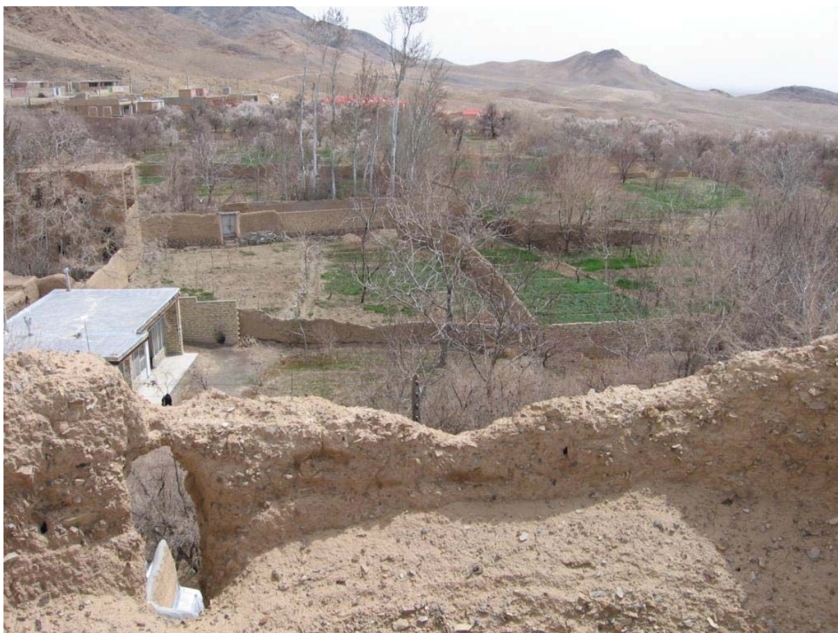
لبه‌های فرسایش شده بام برج و نمای روستا
